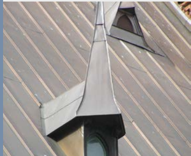
Abb. 142: Dach aus Zinkblech | Quelle: Pko – commons.wikimedia.org, CC BY 3.0
