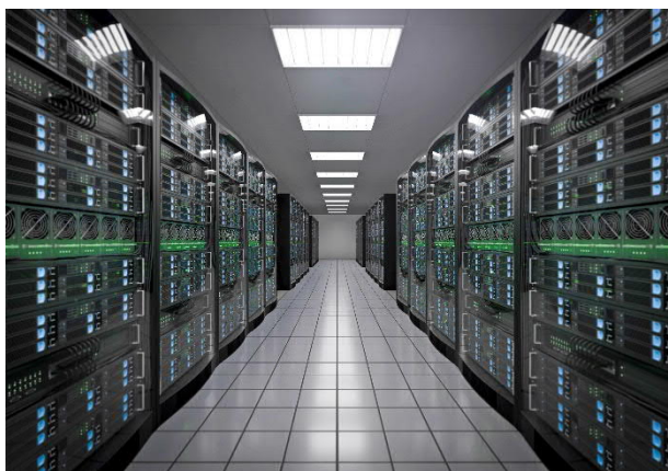
Foto: fotomek – stock.adobe.com Serverraum eines Datenverarbeitungszentrums
